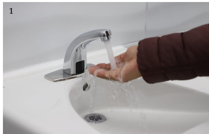
1-3 Se instaló un servicio sanitario equipado según estándares internacionales, para poder atender a personas con algún tipo de discapacidad, que visiten el edificio B del Centro Universitario Metropolitano (CUM).
