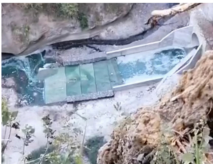
Las aguas desembocan cerca de la Planta de Tratamiento de la USAC de manera controlada.
