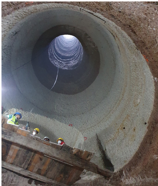
6 pozos de visita quedaron habilitados.
